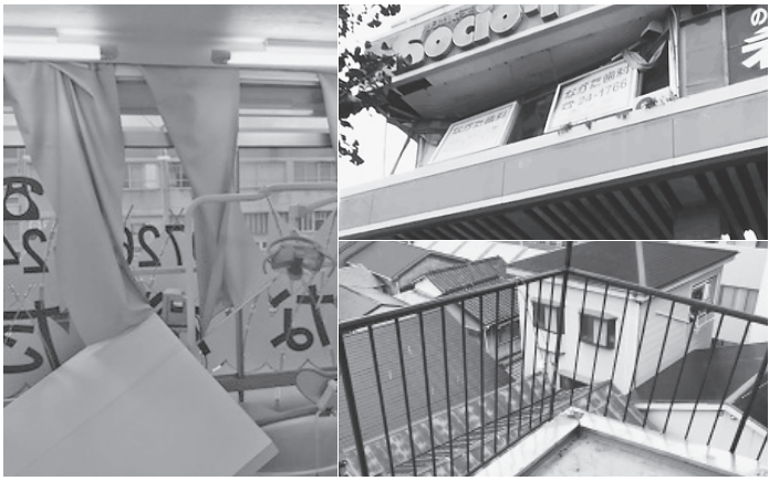
看板が窓ガラスを突き破った（茨木市・ながた歯科/左、右上） 根元から外れた屋上の手すり（大阪市北区・美島歯科医院写真提供/右下）
