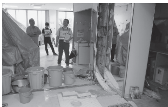
天井や壁が崩れ、雨水をバケツで受ける A歯科 熊本市中央区
